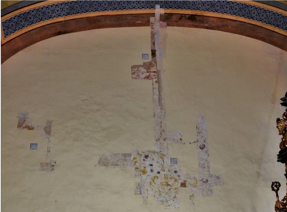
slika 14: sjeverni zid u brodu, stanje prije radova
